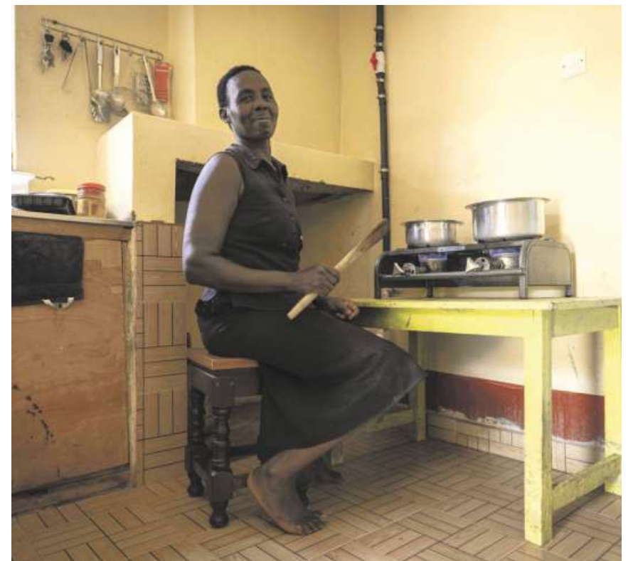
Das Biogas wird mittels einer Leitung zu den Kochherden geleitet.
